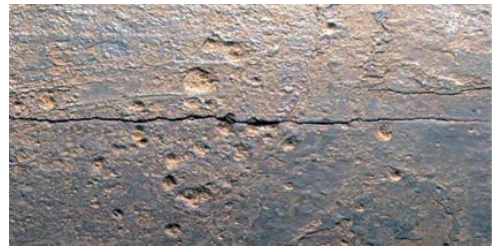
Рис. 3. Стресс-коррозионные дефекты, выявленные на линейной части магистрального газопровода Ухта — Грязовец — Торжок диаметром 1220 мм [1]
